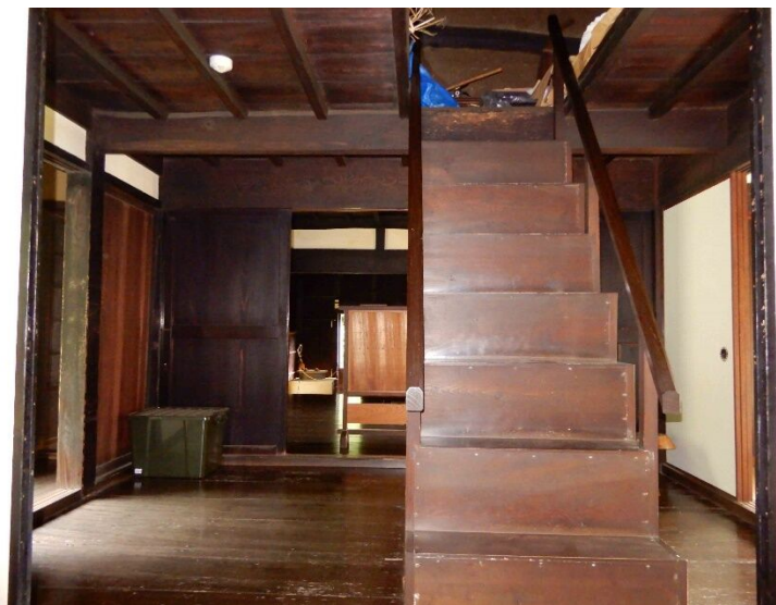
中の間置階段の中段位にも雨漏り箇所あり
