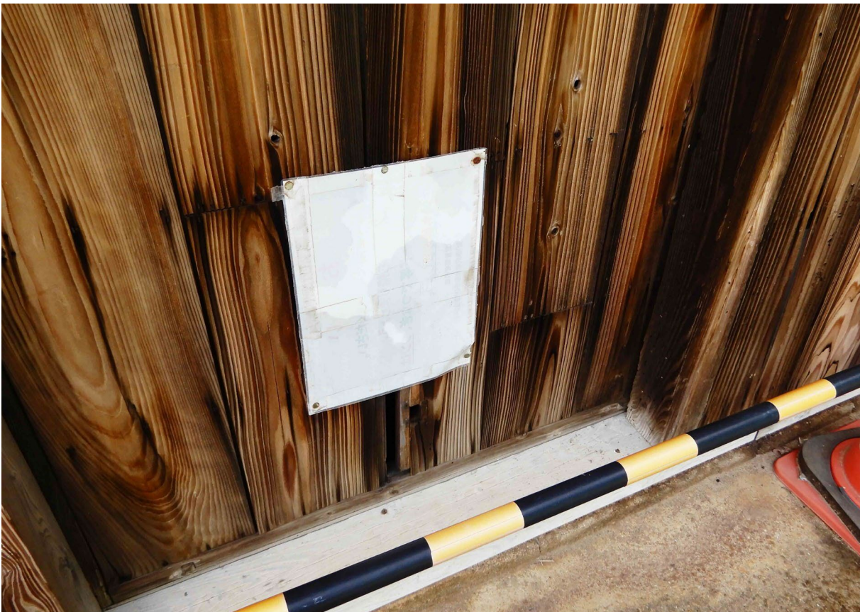
同上 板戸の板破損部分
