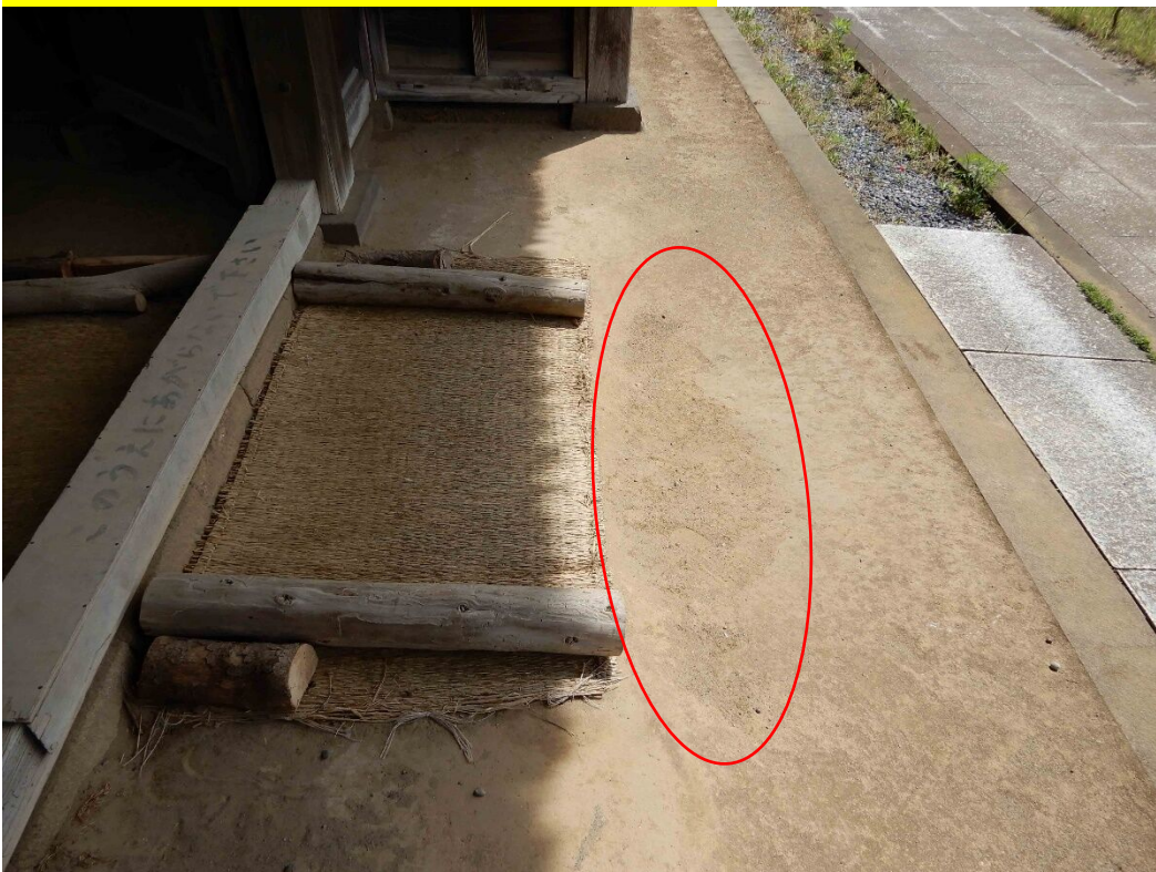
旧福原家長屋門 正面通路部分の土間叩きの凹み部分 ○部分が最大6cm程凹んでいる。
