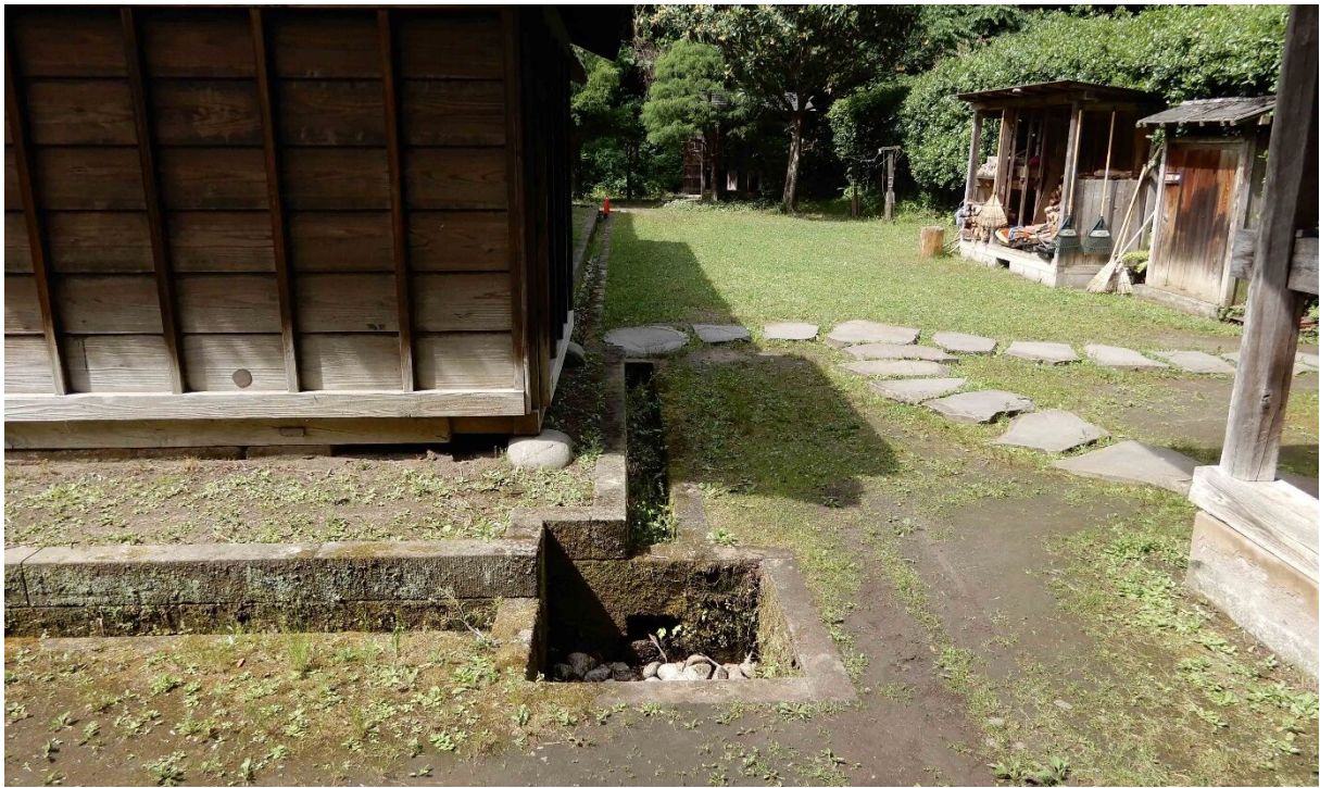
旧小池邸 主屋 雨落ち排水 東北隅の柵の危険性
