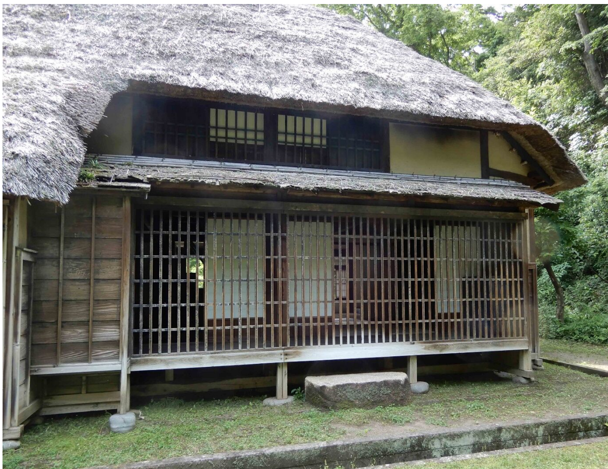
旧小池邸 主屋 背面西半部の縁側杉皮屋根の破損状況
