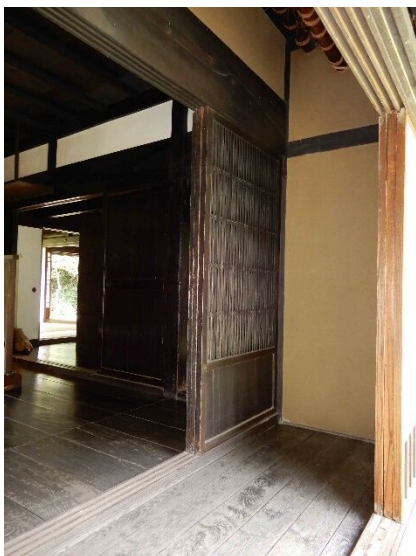
居間背面縁に雨漏り箇所あり
