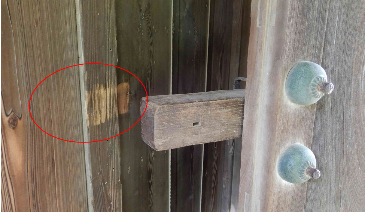
旧福原家長屋門 通路扉門による柱と壁板の破損 扉の開閉時に門が柱と壁板をこすって傷付けている。
