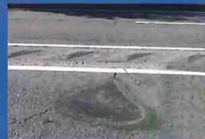
穴ぼこを補修し、安全を確保！
